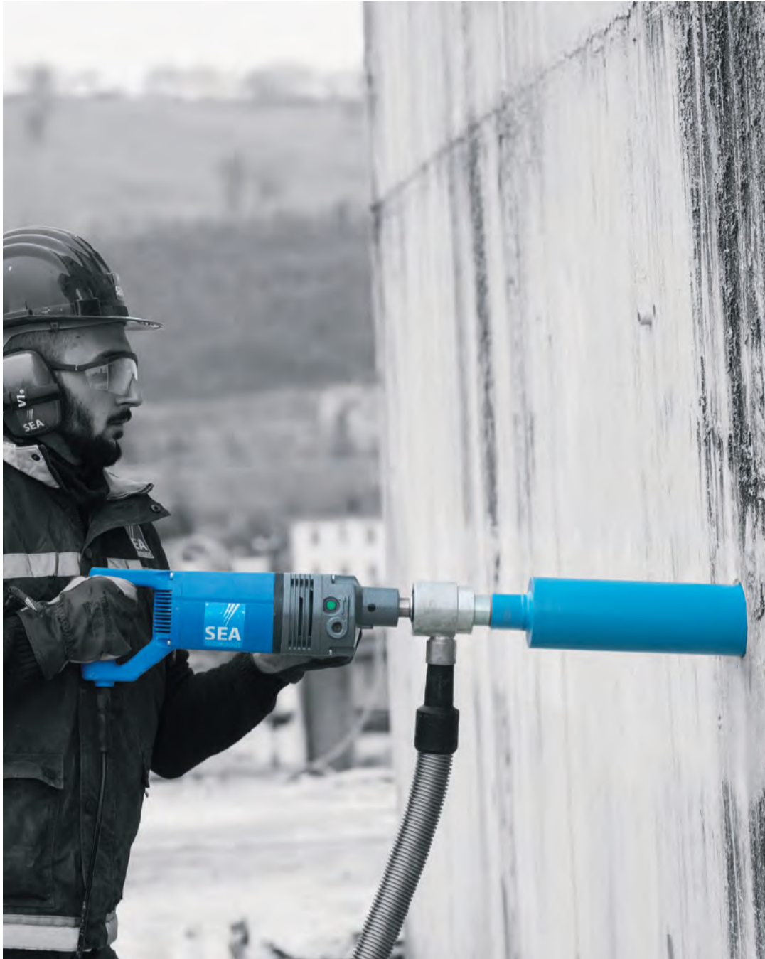
Sistema per carotaggio a secco con aspirazione di SEA Technology
